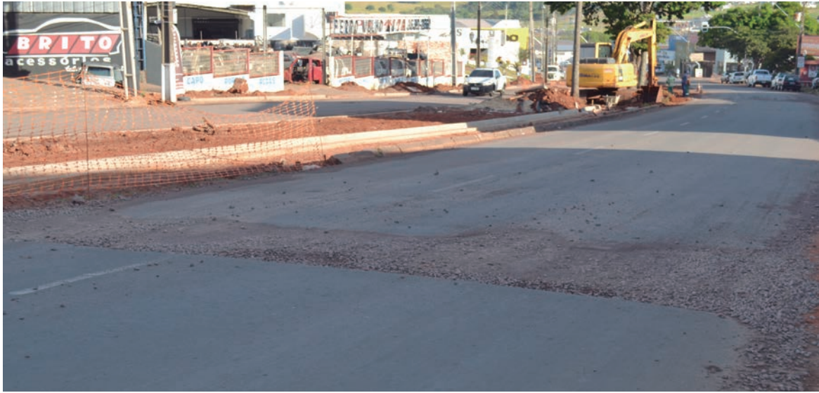
AO fechar as valetas após a execução das obras, empresa que realizou o serviço deverá deixar o 'asfalto liso'
