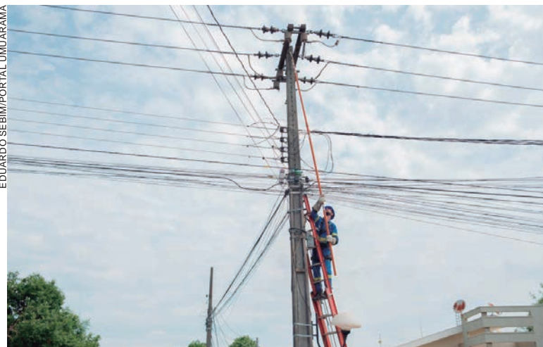
HOUVE registro de falta de luz em alguns bairros da cidade e vários semáforos ficaram inoperantes, gerando transporte e um aumento de atenção por parte dos motoristas
