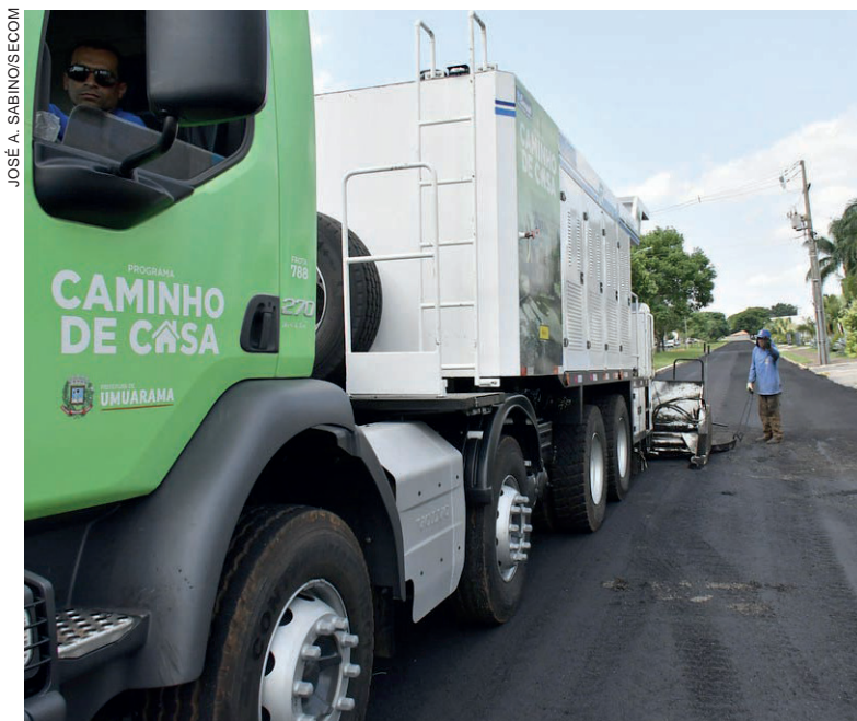
A escolha pelo processo de micropavimentação levou em conta aspectos como tráfego de veículos, rapidez na execução e também custo-benefício
