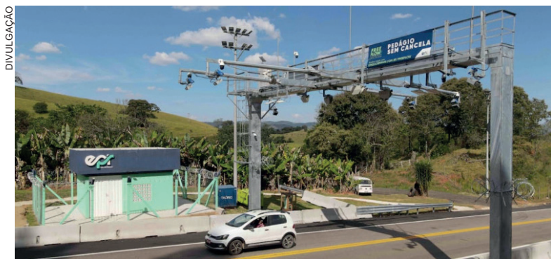
O sistema de cobrança por pórticos eletrônicos começou a ser implantado em 627 quilômetros de rodovias, incluindo trechos das BRs 272, 369 e 376
