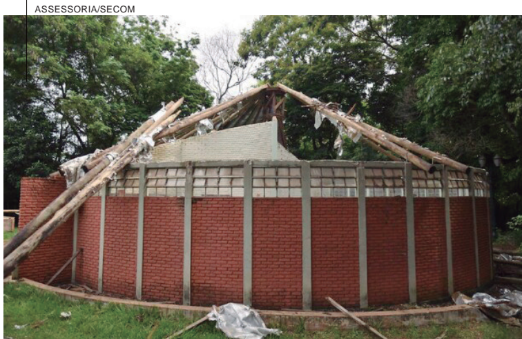
Construída na entrada do Bosque dos Xetá, a Sala Aré foi criada para ser um ambiente destinado à educação ambiental. Abandonada há vários anos, enfrenta problemas estruturais e vem se deteriorando. Agora o prefeito Hermes Pimentel publicou a Portaria 1696/2021, homologando o início das obras de reconstrução. A empresa Construtora Trigama será responsável pela obra, que terá 181,45 m² e receberá investimento de R$ 245.827,21 em recursos do próprio município. “O prazo de execução será de seis meses, a partir da expedição da ordem de serviço. Será construída uma estrutura de madeira com área mínima de 90,72 m², mantendo o modelo original, que remete a uma oca indígena”, detalha o secretário Isamu Oshima.
