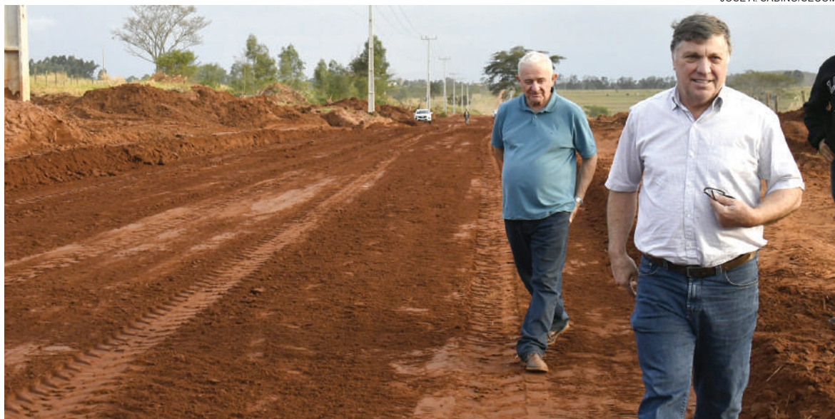
Prefeito Celso Pozzobom visitou a estrada ontem e acompanhou o andamento das obras
