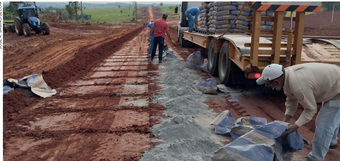
A via rural atende produtores de diversas propriedades, facilitando o acesso ao São Cristóvão e, a partir do bairro, à rodovia PR-323
