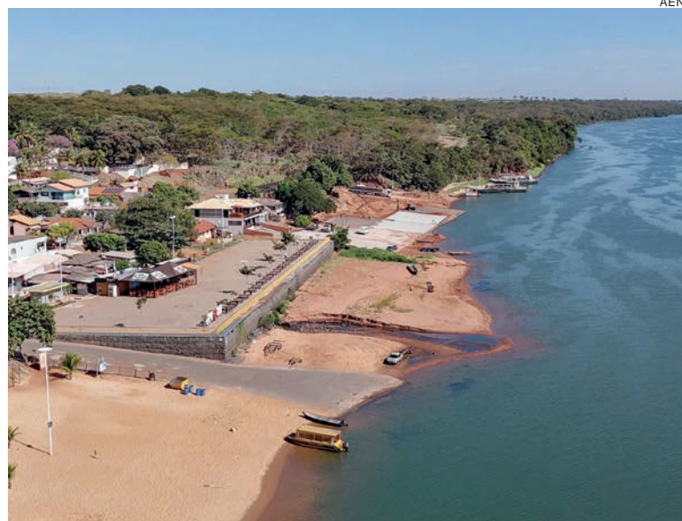
Em São Pedro do Paraná, uma rampa náutica para embarque e desembarque está sendo construída em Porto São José
