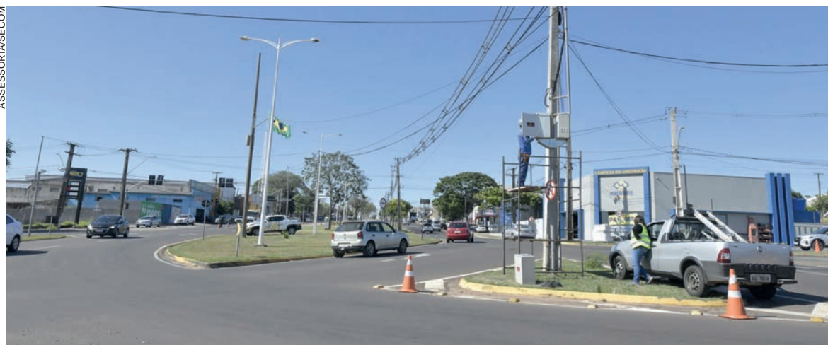
Mais 20 equipamentos estão em processo de análise para compra pela Divisão de Engenharia de Trânsito
