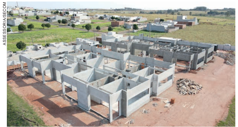
O investimento gira em torno de R$ 4 milhões e a empreiteira concluiu as fundações, ergueu e está rebocando as paredes
